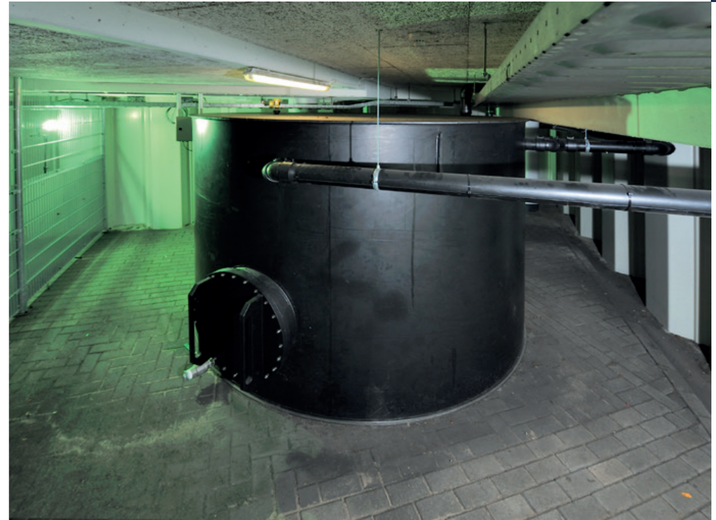
Opvangtank in de kelder/ parkeergarage van AFAS Live, fosfaatwinning uit afvalwater
