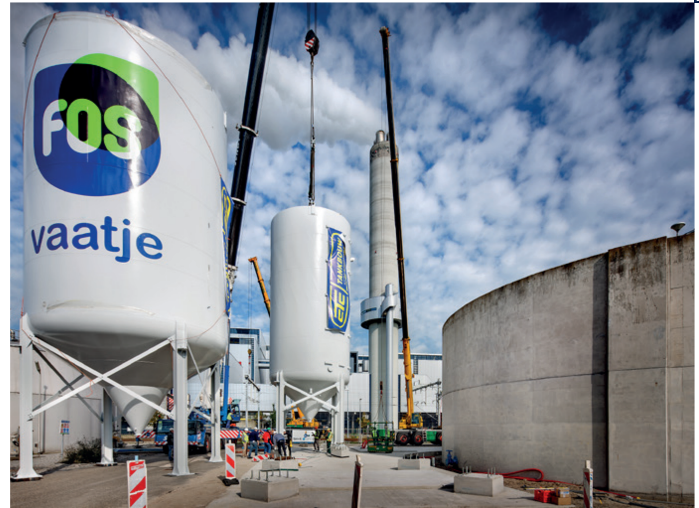
De fosfaatfabriek op RWZI Amsterdam West, van Waterschap Amstel, Gooi en Vecht
